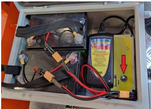
Foto 18. Sistema elettrico di discesa
